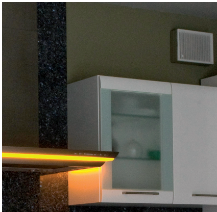
Fettfilter AFR 01 in einer Wohnküche
