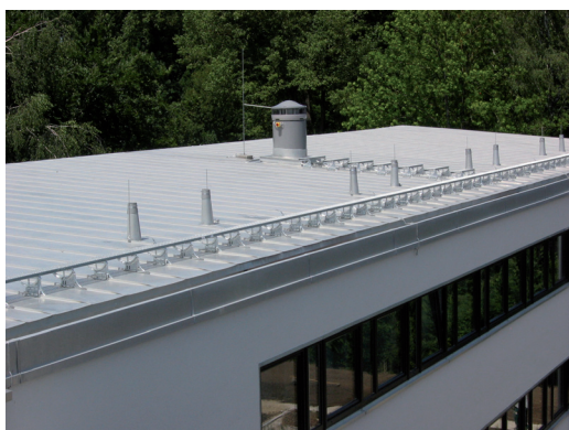
Die druckgeregelten Dachventilatoren DVS 300 und DVS 500 halten einen Unterdruck im Schacht konstant. Dies ermöglicht eine permanent am Bedarf angepasste Absaugung der verbrauchten Luft
