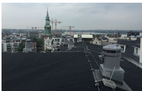
Die Abluftventilatoren vom Typ DVSR 800 EC / 1300 EC sitzen auf den einzelnen Entlüftungsstränge.
