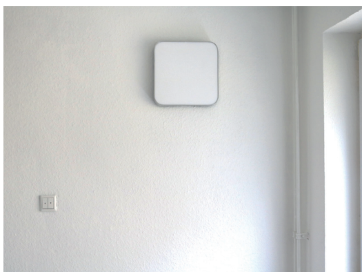
In den Wohnräumen befinden sich die dezentralen Lüftungsgeräte. Sie wechseln, alternierend mit einem anderen Gerät, alle 70 Sekunden die Lüfrichtung
